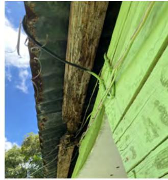
Bianela muss ständig damit rechnen, dass der Trägerbalken ganz durchfault und ihr das halbe Dach auf den Kopf fällt.
